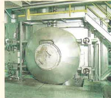
●ボイラドラム
