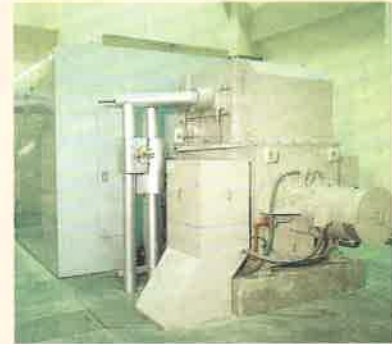
●タービン発電機
