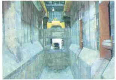
●灰ピット、灰クレーン
