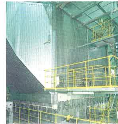
●電気集じん装置
