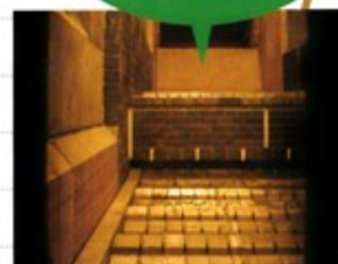
焼却炉の内部
